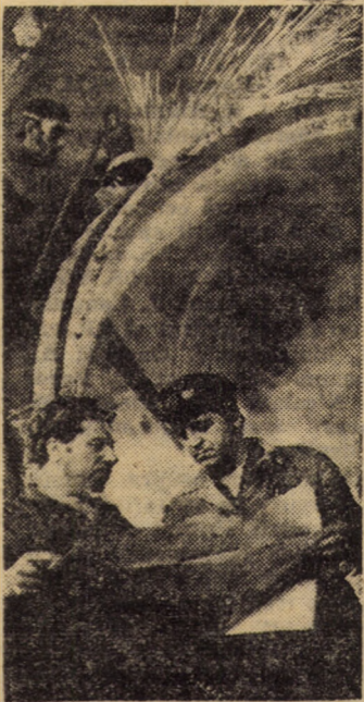
Din munca cazangiiilor sibiieni ai întreprinderii „Independența”: lucrări de finisare la un distribuitor pentru hidrocentrală, conduse de șeful de echipă Ioan Stimeriu. Foto: FRED NUSS
