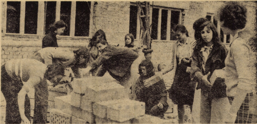
Zilnic, pe șantierul Internat — Liceul de construcții nr. 6 Sibiu — se execută muncă patriotică cu un efectiv de 60 elevi Foto: FRED NUSS
