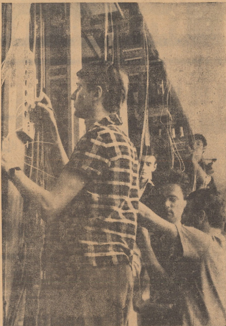
Printre realizările de seamă ale municipiului Sibiu, se va număra în curînd și Centrala interurbană automată, în prezent în fază de montaj. În fotografia de față am surprins pe cîțiva dintre tehnicienii în momentul conectării boxelor de semnalizare cap rînd și curenți speciali
